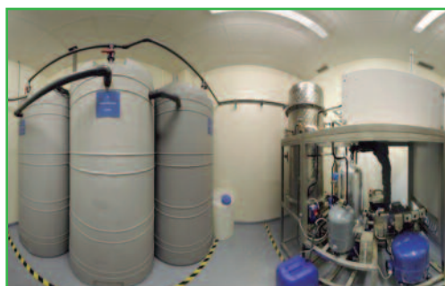
Acumulación y 1ª Fase de tratamiento.
