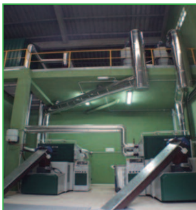
Sala de Calderas.
