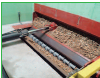
Hospital Calde. Silo de astilla, suelo móvil, sinfín alimentación calderas.
