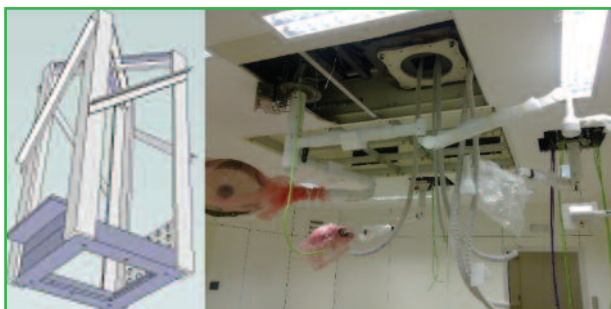
Figura 5. Ejemplo de subestructura de anclaje entre el forjado y la platina de anclaje de la columna de suministros.
