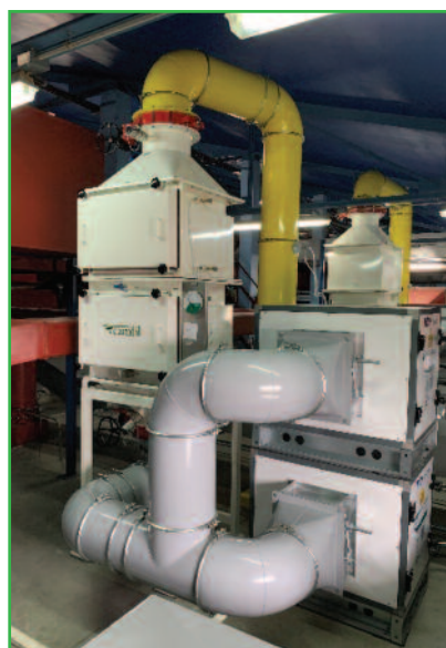
Cajas de filtración HEPA H14 CAMFIL y montaje de VALTRIA, aire de extracción con agentes biológicos del Grupo de Riesgo 3 y 4. Imagen G. Pascual CSIC-INIA-CISA.
