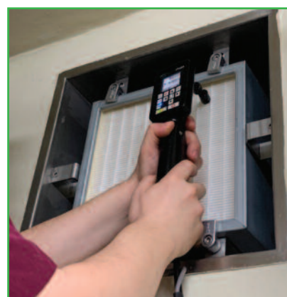
Contaje de partículas sobre filtro HEPA H14 CAMFIL, ajuste en caja terminal en impulsión. Box para SARS-CoV-2. CISA.
