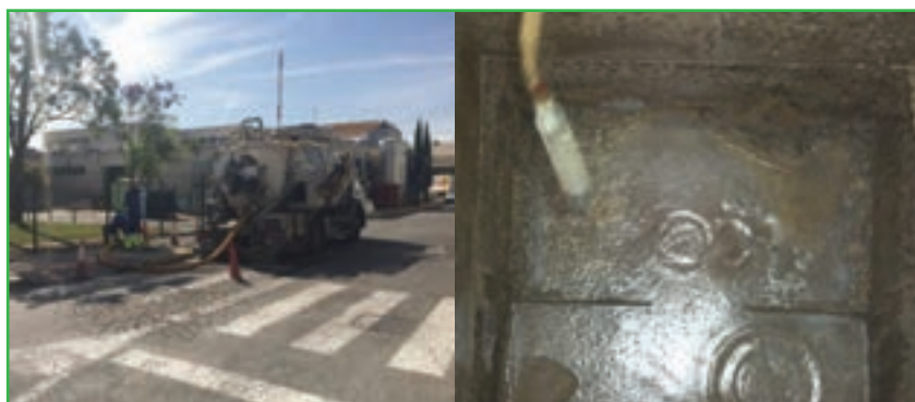
Imagen 1. PTM4 Tren de arquetas de cocina.
